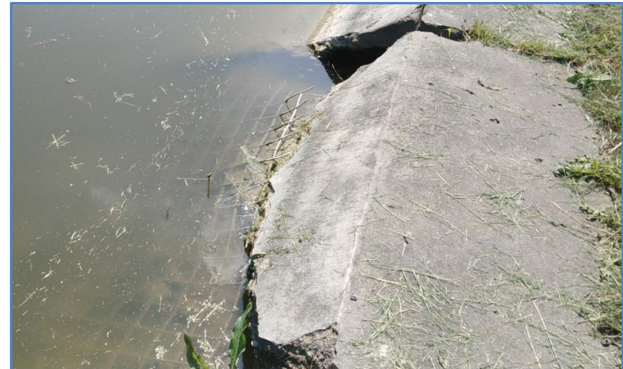
8| Porušené břehové opevnění
